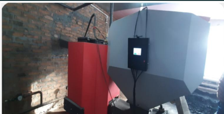
Котел длительного горения с автоматической подачей угля в Дружбинской ООШ (сокращение количества кочегаров)
